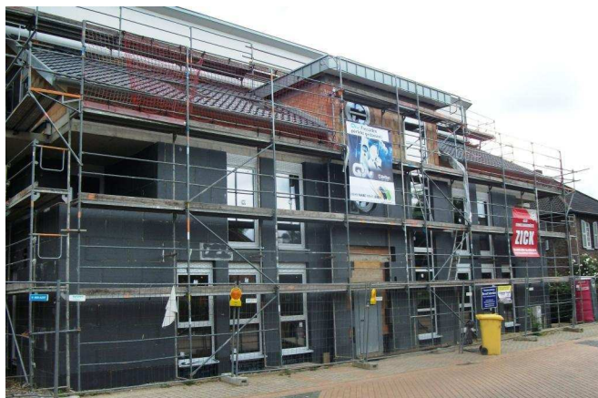
Das neue Haus, das voraussichtlich bis zum Jahresende fertiggestellt wird. Bilder: GVS-Archiv
