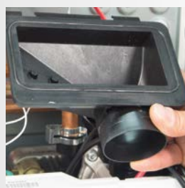
Ispezione raccolta condensa
