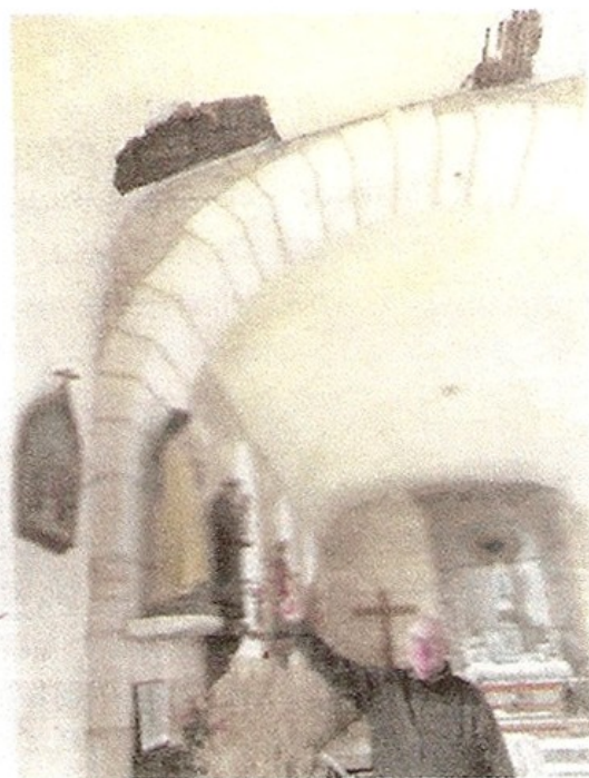
Le bois qui soutient le plâtre est très imbibé d'eau.
