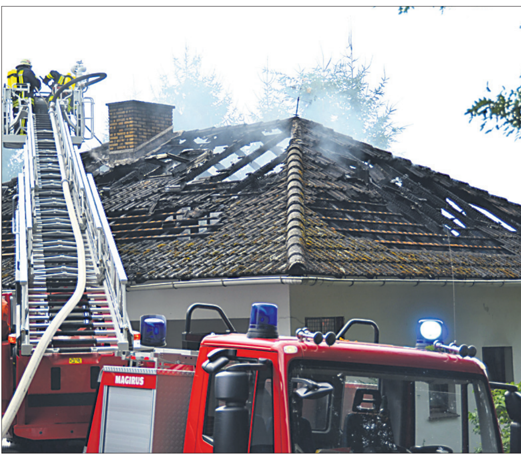
Fast vollständig ausgebrannt ist gestern Nachmittag dieses Wohnhaus im Osterloh in Hitzacker. Personen wurden bei dem Feuer, das sich rasend schnell vom Außenbereich des Einfamilienhauses auf den Innenbereich ausbreitete, nicht verletzt. Aufn.: T. Lieske
