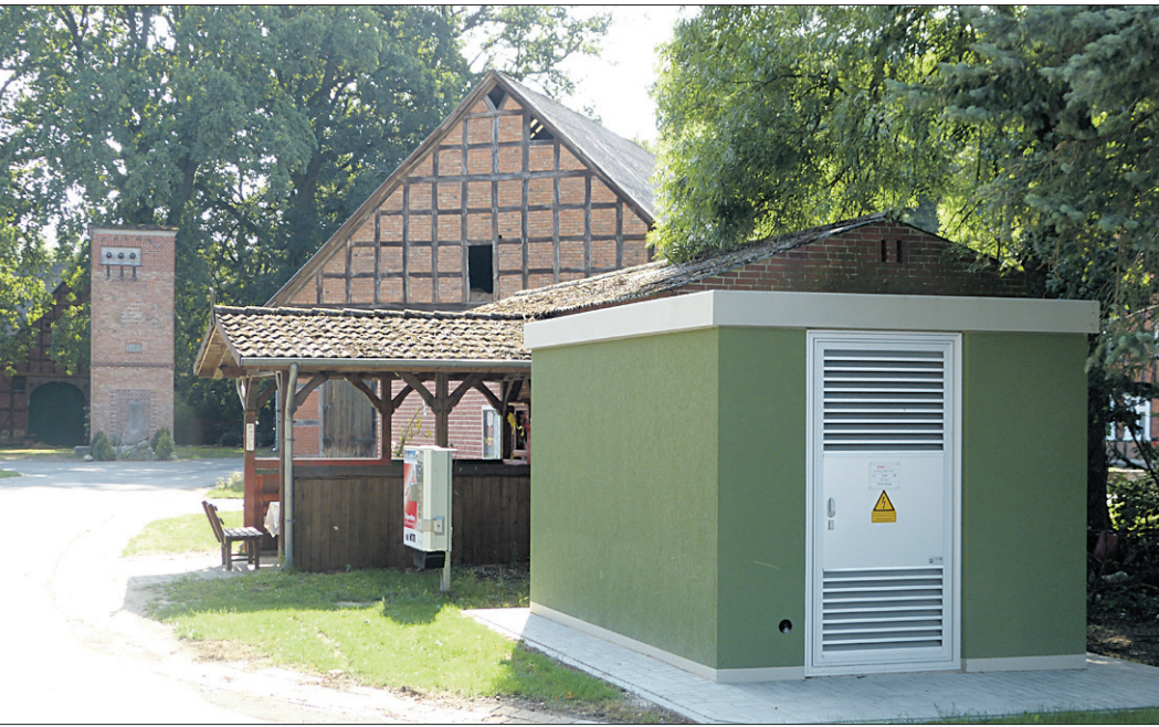
Im Zuge des Netzkonzeptes Wendland ist in Klein Breese diese neue Avacon-Schaltstation installiert worden. Das zu Hastra-Zeiten errichtete Transformatoren-Gebäude (hinten links) hat ausgedient.
