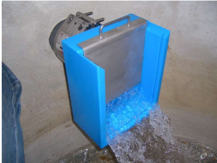
Tauchwand komplett eingeschoben Das Wasser muss jetzt unter der Tauchwand hindurchfließen
