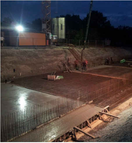
Sickerbecken im Pilgerschrittverfahren Hofbräu, München
