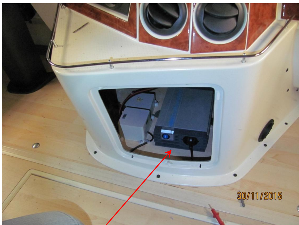
Bild 6: Inverter (Umspanner) für Frontrollo
