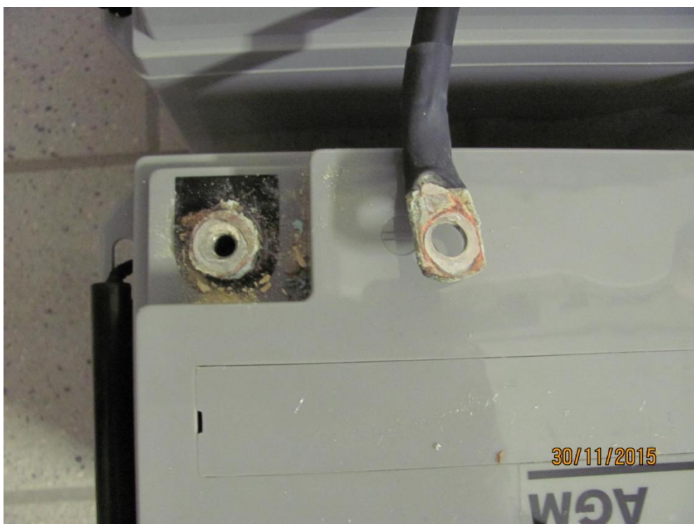
Bild 2: Korrosion am Anschlusspol
