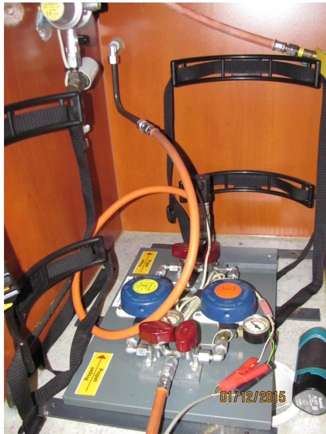
Bild 14: Gasversorgung von Fa. Truma
