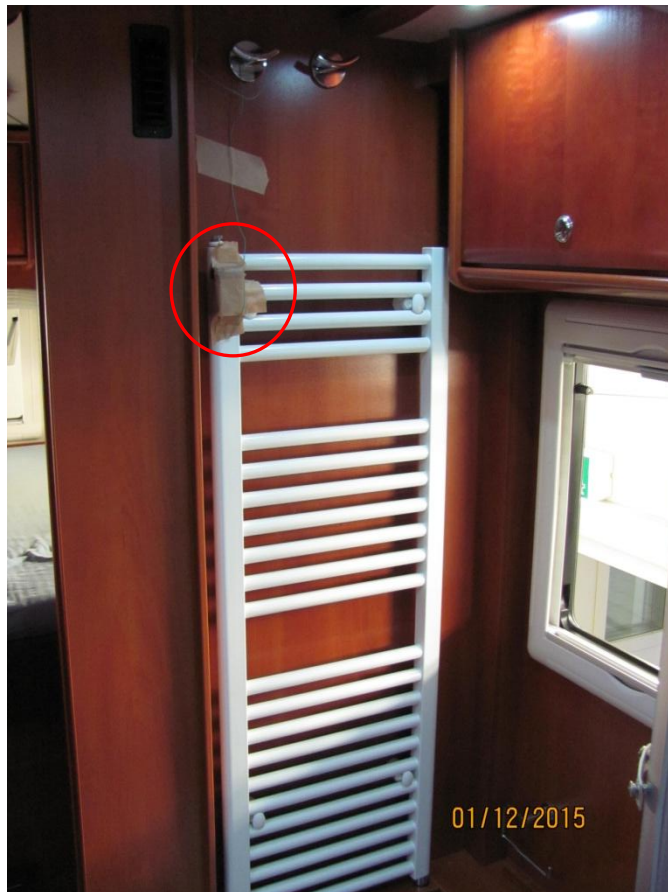
Bild 12: Badheizkörper mit Messfühler
