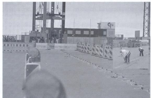
Bild 34: Eingedrückte Sonden im Asphalt einer Hafenfäche
