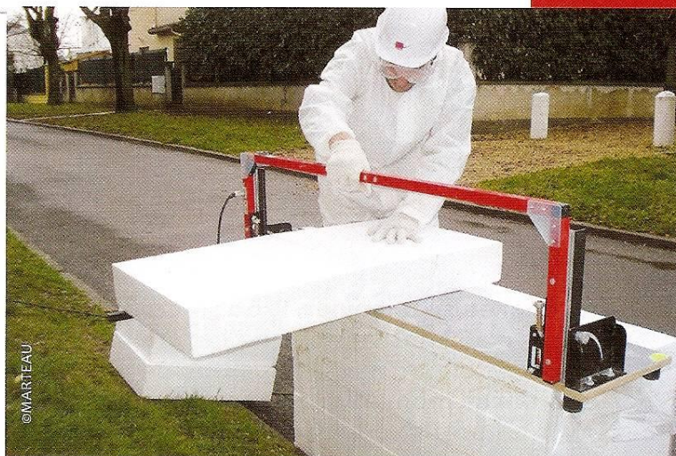
▲ UNE MACHINE À FIL CHAUFFANT A ÉTÉ UTILISÉE POUR UNE DÉCOUPE PROPRE DU POLYSTYRÈNE ET ÉVITER LA DISPERSION DE BILLES CONFORMÉMENT À LA CHARTE ENVIRONNEMENTALE DU CHANTIER.
