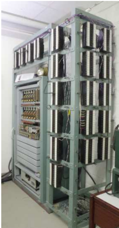
Der HVT am Aufstellort mit eingeschobener Telefonanlage
