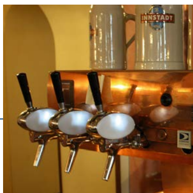
Vorhandene Zapfstation; erweitert
