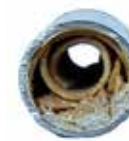
Rohrleitung 10 Jahre alt
