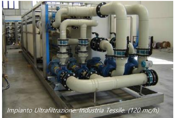
Impianto Osmosi Inversa a doppio passaggio e doppi stadio di concentrazione per acqua ultra-pura (20 m 3 /ora.)
