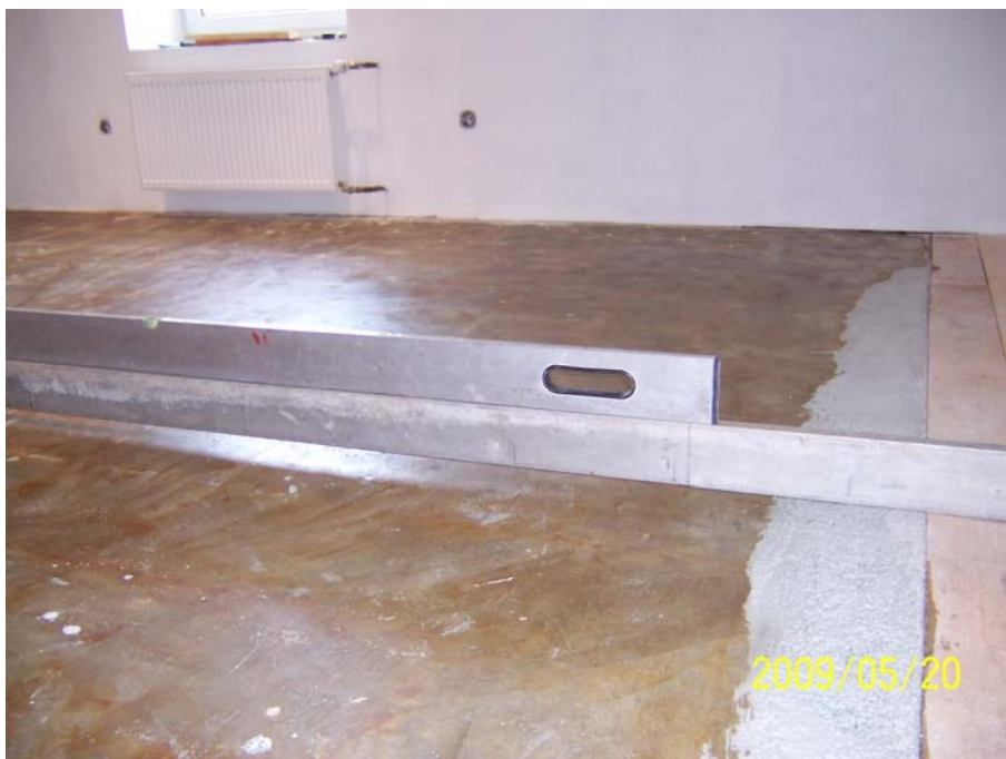
Bild 7: Baustelle – durchhängende Decke unter Richtlatte
