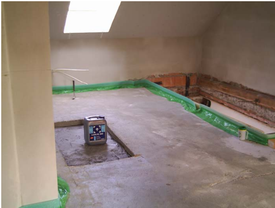
Bild 3: Untergrund mit Ausbruch
