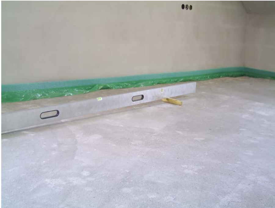
Bild 8: Baustelle – durchhängende Decke, nivelliert mit UZIN NC 194 Turbo
