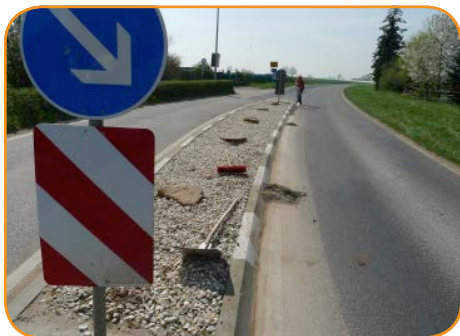
Fahrbahnleiter nach Meckenheim ge- staltet.
