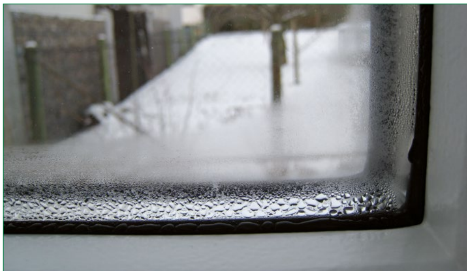
Fig. 3 : de légères traces d'eau de condensation peuvent se former au bord de la vitre en raison de l'intercalaire en aluminium à l'intérieur du vitrage isolant.
