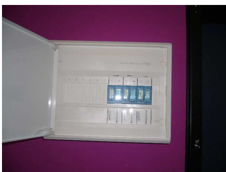
Abb. 1: Energie- und Betriebsstundenzähler
