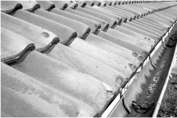
Bild 2: Typische Frostschäden an engobierten Tondachziegeln (Freigelände Holzkirchen).
