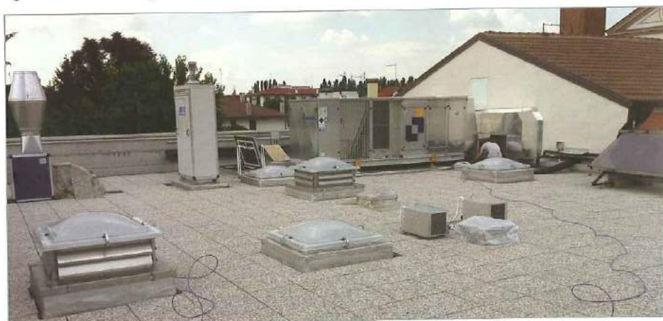
La copertura piano dove sono collocati gli impianti
