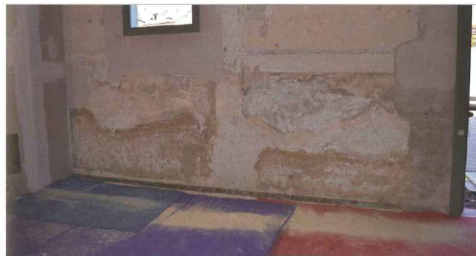
Stato degli intonaci interni.
