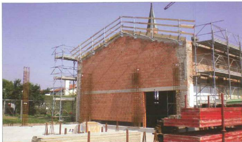
Ricostruzione della fatiscente parete sud del vecchio teatro.
