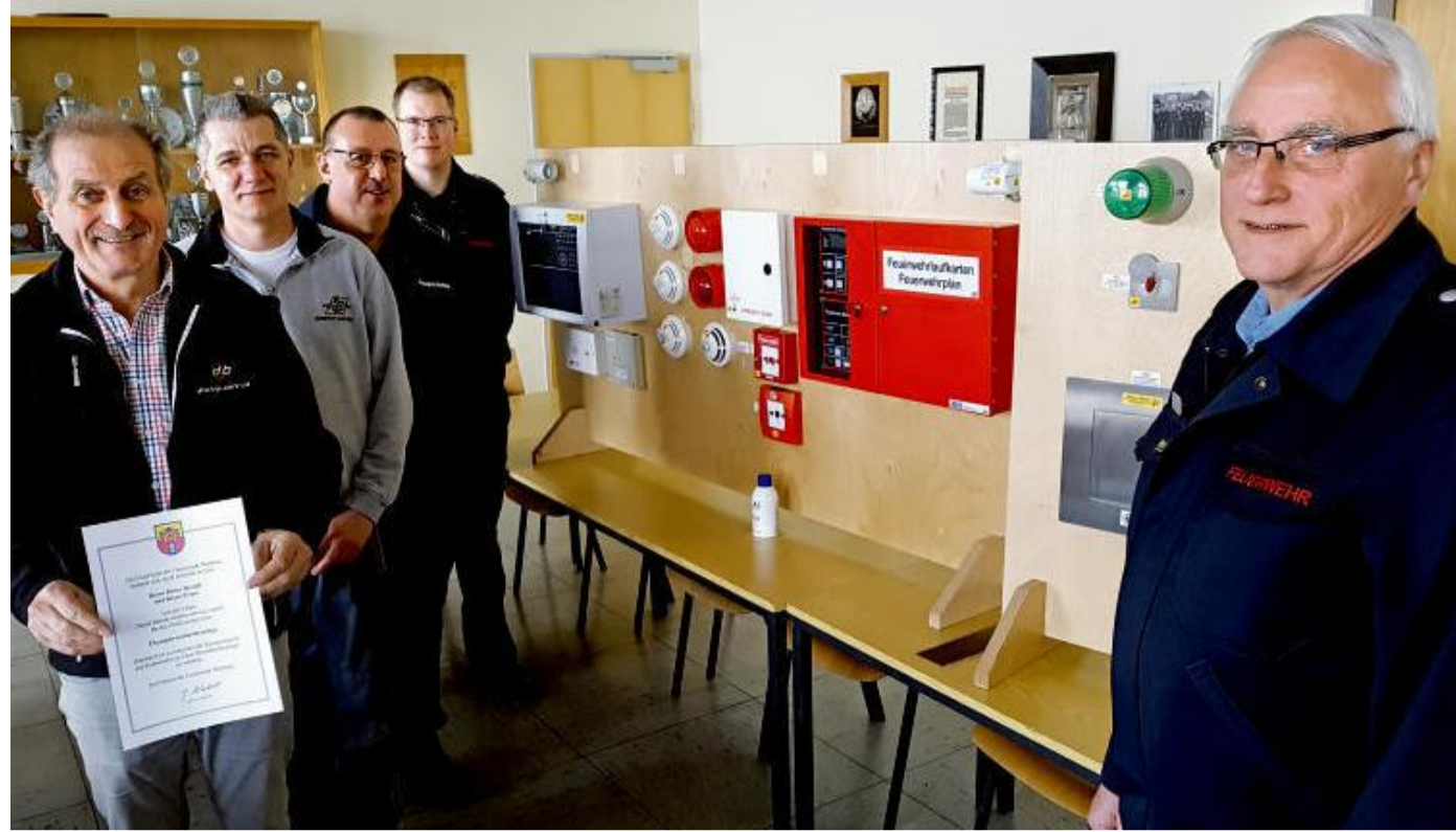
Freude über die gespendete Brandmeldeanlage: Dieter Berndt von der gleichnamigen Firma in Vellmar, sein Mitarbeiter Klaus Frieze, Brandinspektor Johannes Hellmuth, Pressesprecher Christoph Fuest sowie Josef Wakob (rechte Seite). FOTO: KATHARINA ENGELHARDT
