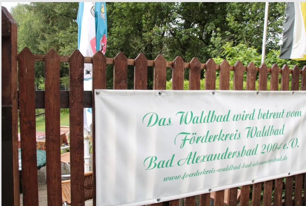
Auch das Tor und der Zaun am Eingang des Waldbades wurde durch einen Prüfer beanstandet, da zwischen den Zaunlatten jeweils 5 cm Abstand sind, aber nur max. 4,5 cm auseinander sein dürften, da sich ansonsten Kinder beim Klettern darin mit dem Kopf verfangen könnten. Zur Sicherung wurden oben nochmals Querlatten angebracht.
