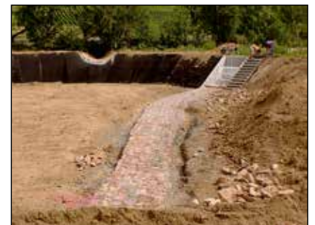
Regenrückhaltebecken „Misch- und Gewerbegebiet“
