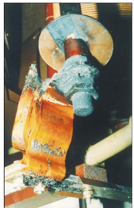
Bild 6 Schaden an einem 110/10 kV Transformator durch Überhitzung
