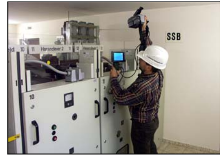
Bild 2 getrennter Aufbau von Monitor und IR-Kamera
