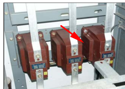
Bild 12 defekter 20 kV Wandler
