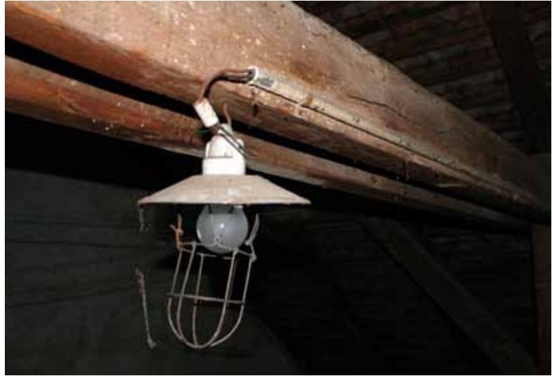
Bild 10: Brandgefahr durch schlecht isolierte Leitung für eine Leuchte im Dachgebälk
