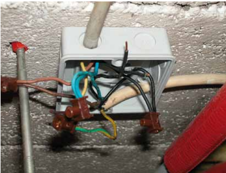
Bild 9: Personengefahr durch offene Abzweigdose im Handbereich
